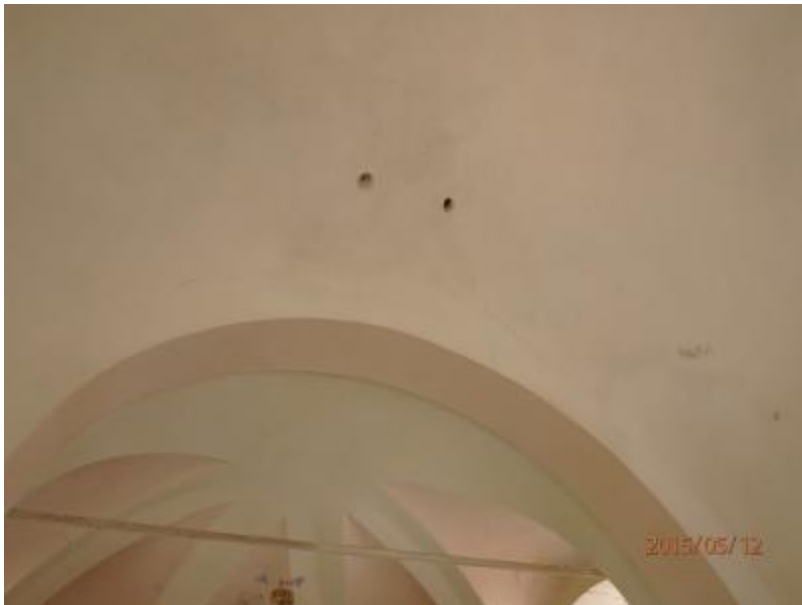
F 38 trhliny v klenbě
