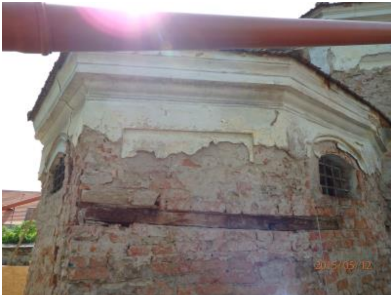
F 30 sakristie Z fasáda – dřevěný hranol ve zdivu
