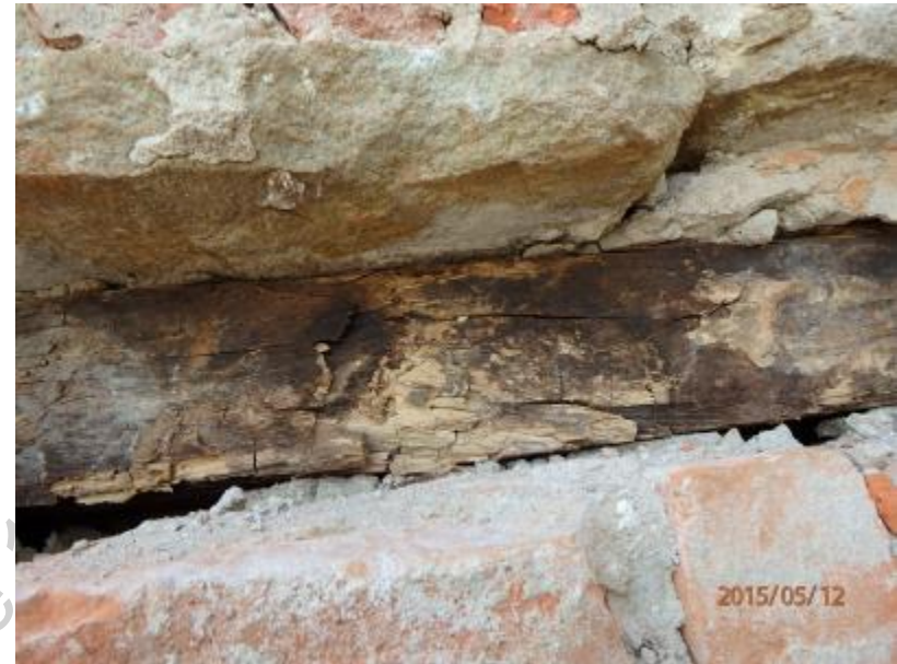
F 31 sakristie Z fasáda – hloubkově poškozený hranol
