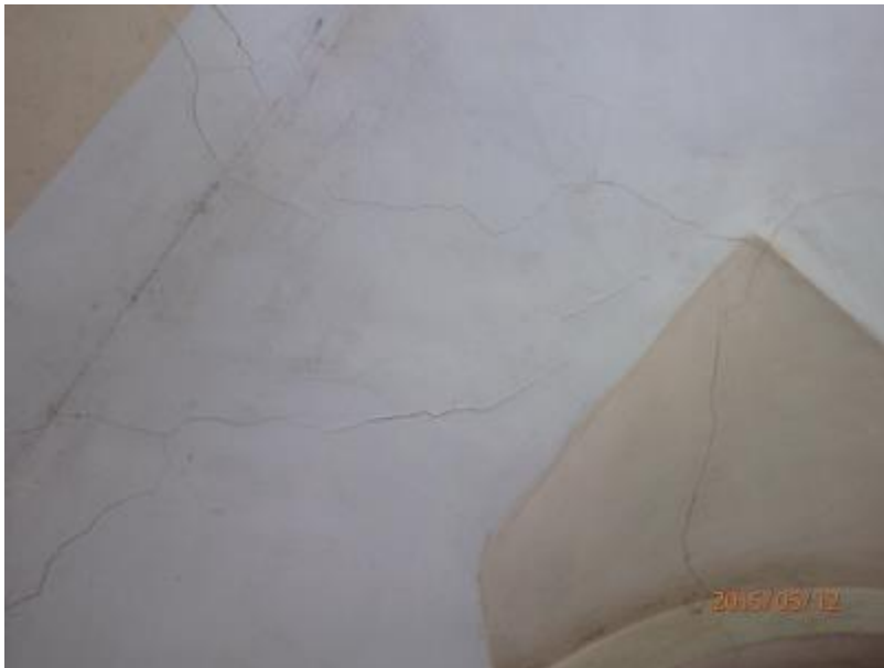
F 46 sakristie trhliny v klenbě
