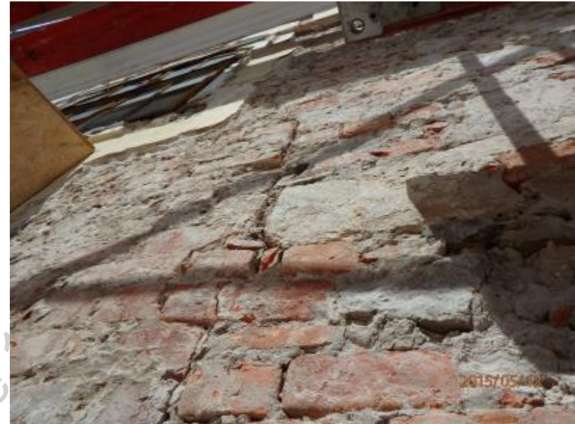
F 7 východní fasáda – trhlina v parapetní stěně
