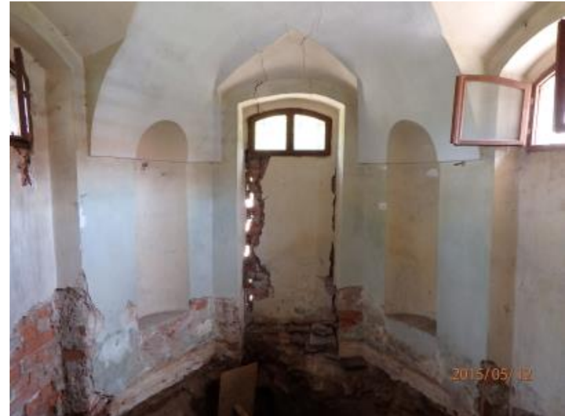
F 11 sákristie (přístavek) 12.5.2015 S stěna
