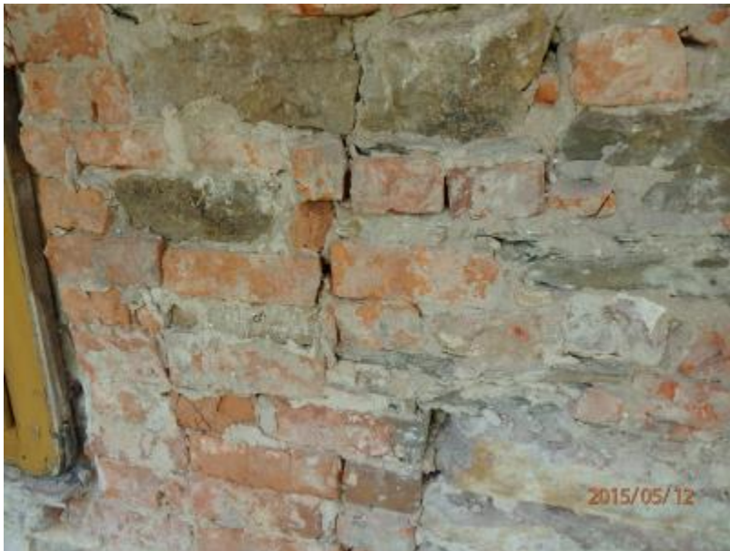
F 14 západní fasáda – horní vpravo do okna trhlina
