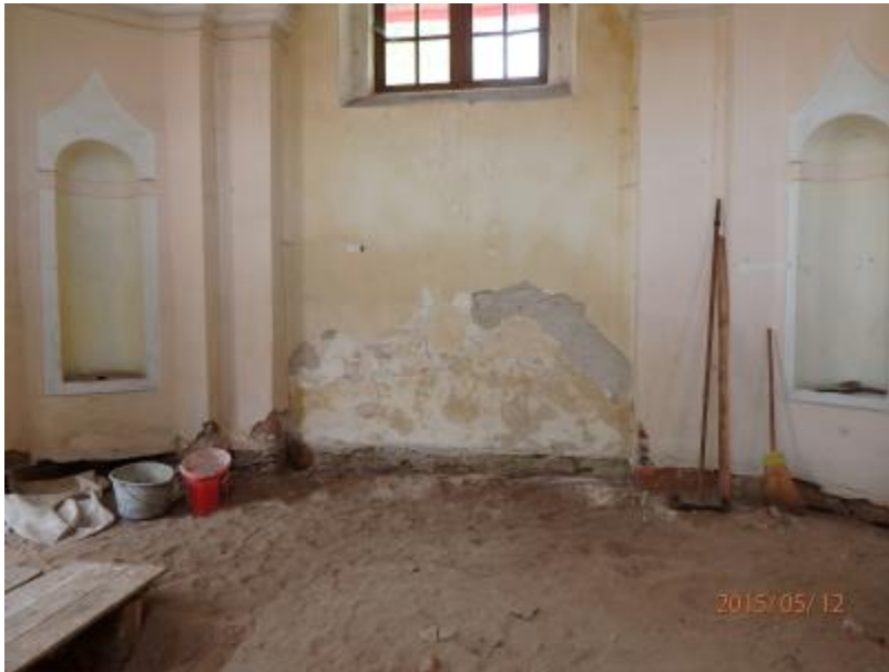
F 41 Z stěna – poruchy způsobené vlhkostí
