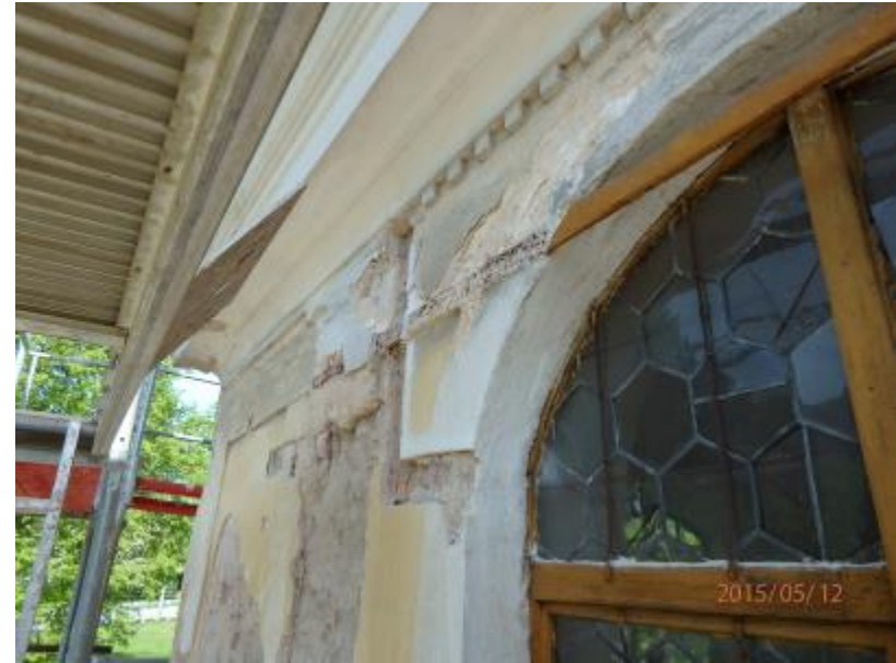
F 4 jižní fasáda – ocelová pásovina přes okenní otvor
