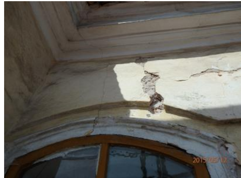
F 12 východní fasáda (presbytář) – trhlina v nadpraží
