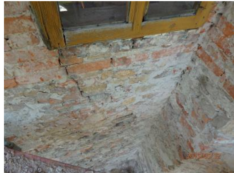
F 20 západní fasáda (presbytář) trhlina od dolního rohu okna
