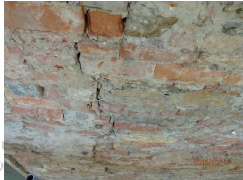
F 15 západní fasáda – parapetní stěna trhlina
