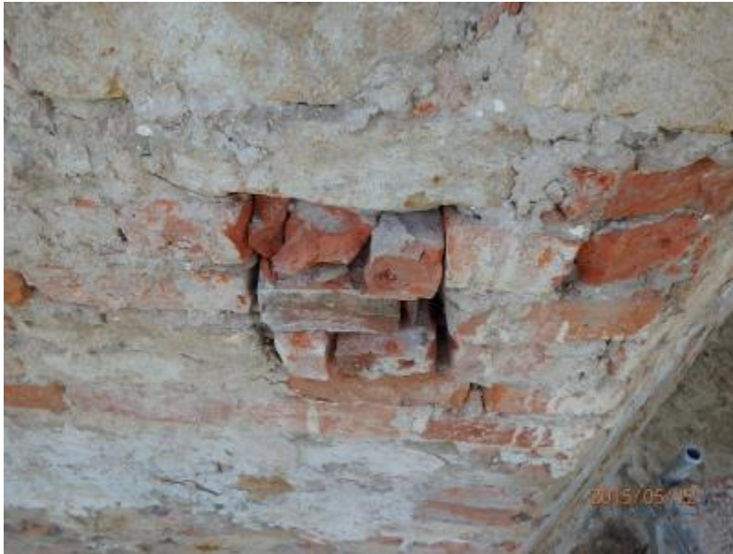
F 21 západní fasáda SZ roh volné cihly v otvoru ve stěně
