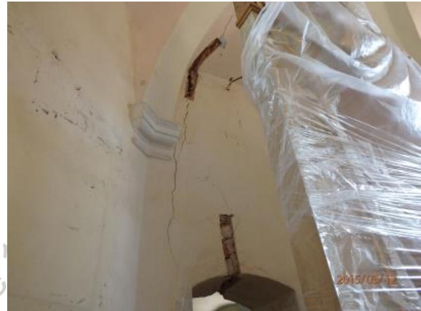
F 43 S stěna - trhliny
