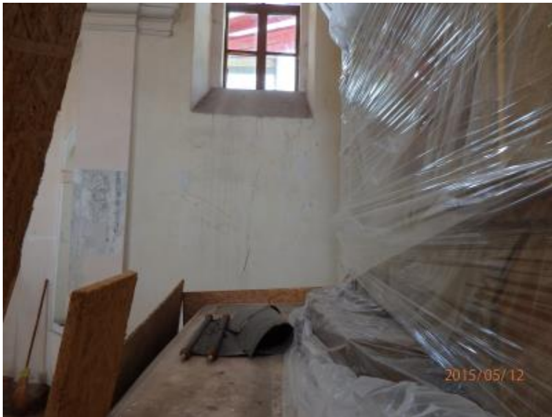
F 42 Z stěna – šikmé trhliny ve stěně
