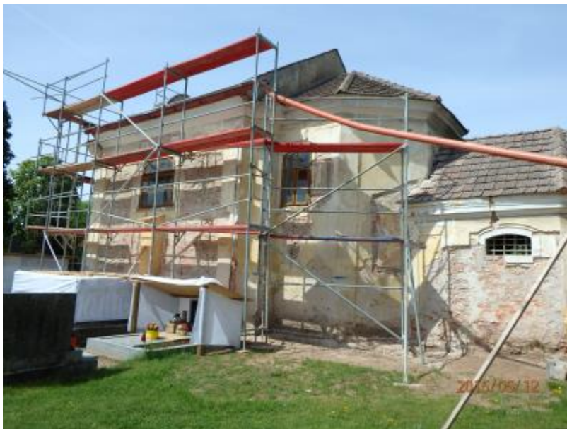
F 17 stav ze dne 12. 5. 2015 východní fasáda
