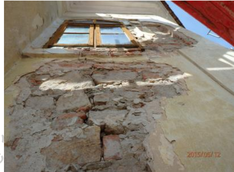
F 11 východní fasáda (presbytář) – trhlina a vazby zdiva
