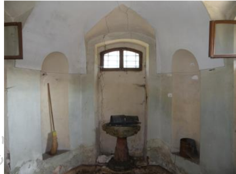
F 10 sákristie (přístavek) 23.4.2014 S stěna
