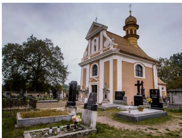
Tatáž hřbitovní kaple Sv. Kříže jak jsme ji opouštěli v r. 2015. Vertikalita už nám nechyběla. Jako jediná stavba celého areálu nemá pozdně klasicistní zelenou, ale naši ranně barokní okrovou.
